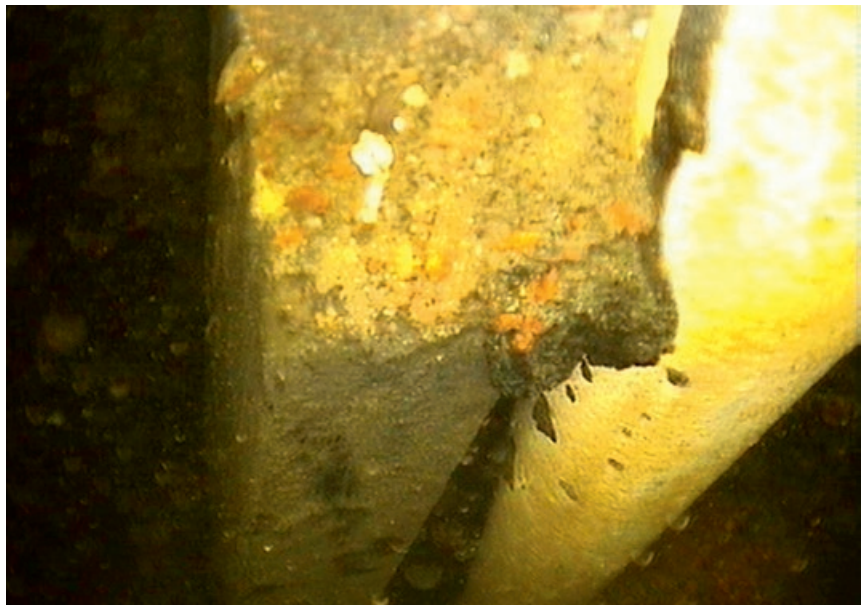
Abb. 1 – Ein Betonpfeiler und eine Pumpensteigleitung in einem Altbrunnen machen eine weitere Befahrung unmöglich.
