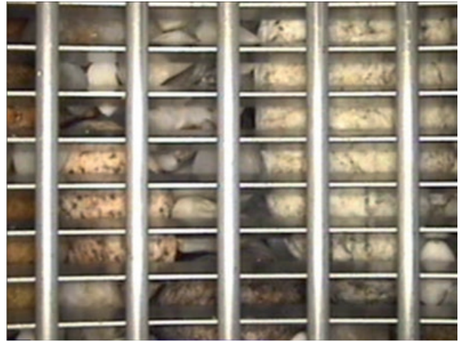
Abb. 7 – Horizontalblick im Bereich des Edelstahl-Wickeldrahtfilters mit mehreren senkrecht verlaufenden Stützstäben und vertikal angeordneten Filterstegen
